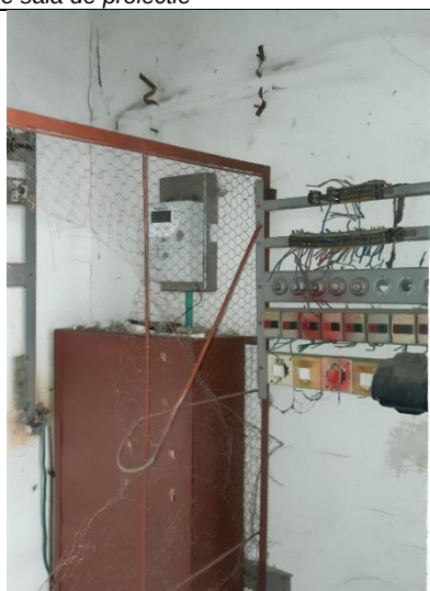
Vedere instalatii – tablou electric general
