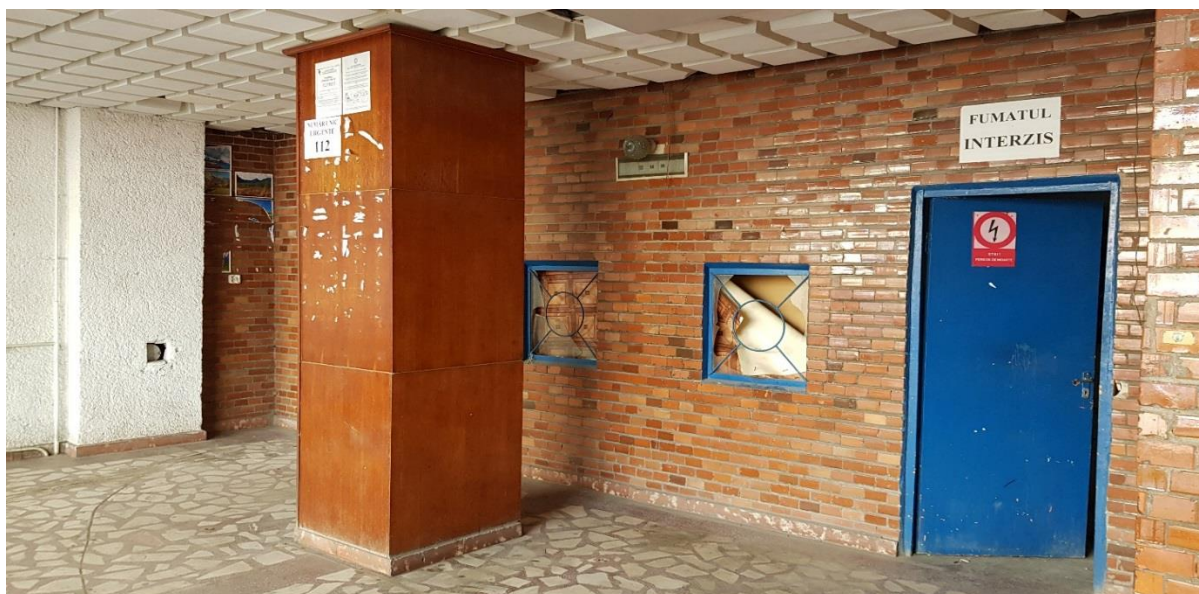
Instalatie de hidranti dezafectata
