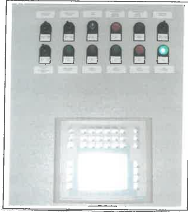
Figura: comutatoare care trebuie controlate/acționate la pornirea instalației de balotare
