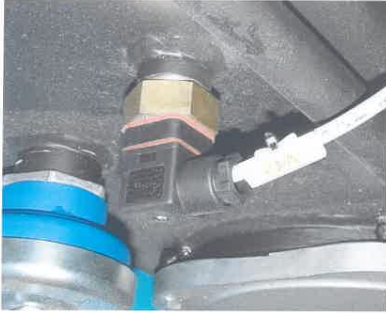
Figura 23: nivel senzor de temperatură
