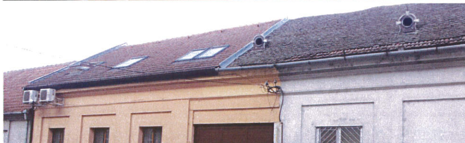
Reabilitări parțiale a acoperișului și inserarea de ferestre "tip Velux": Str.Timocului nr.19, Str.Comănești nr.2
