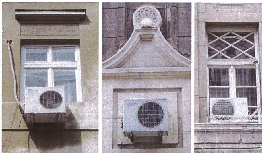
Aparate de aer condiționat montate pe clădiri istorice protejate (aprilie-mai 2015)
