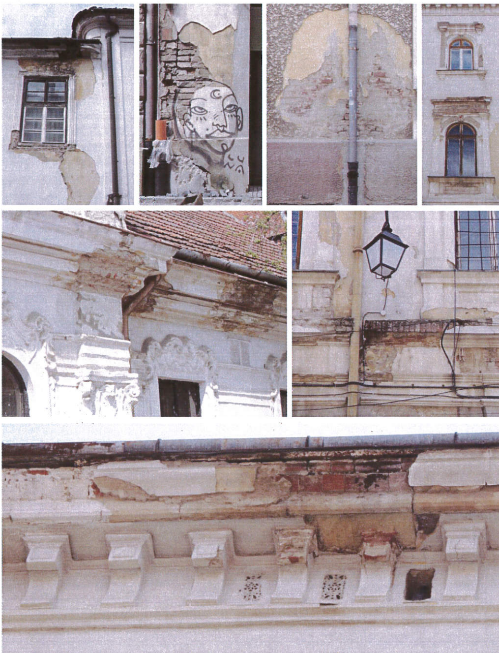
Degradări prezente la nivelul imobilelor aparținând Ministerului Apărării Naționale din Piața Libertății (Cercul Militar și Garnizoana Timișoara)
